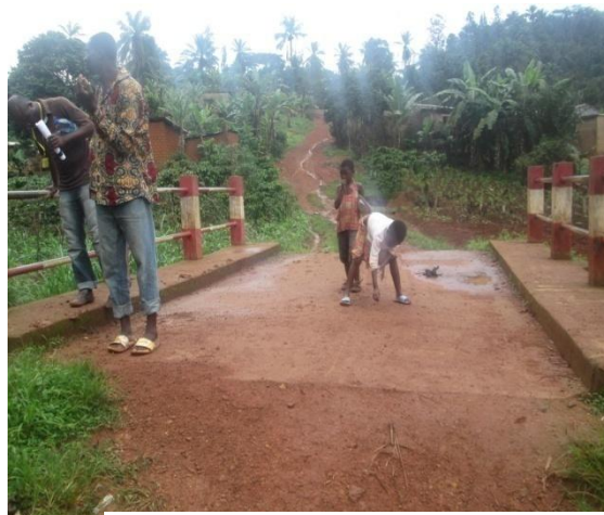
N° 2 : Un ponceau mal entretenu
